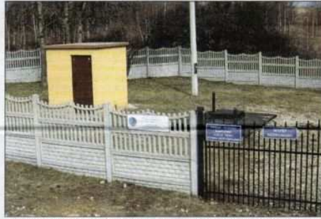
Dąbrowskie PWiK posiada obecnie cztery własne ujęcia wody głębinowej: w Ujejscu, Żąbkowicach, Trzebieśławicach oraz Tucznawie.
