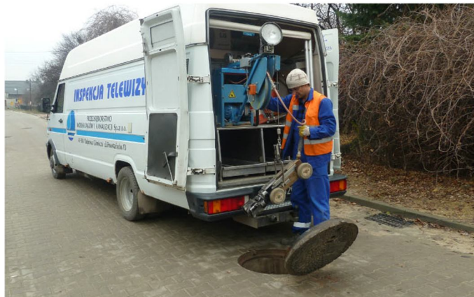
► Monitoring sieci kanalizacyjnej na ul. Głowackiego w Dąbrowie Górniczej
