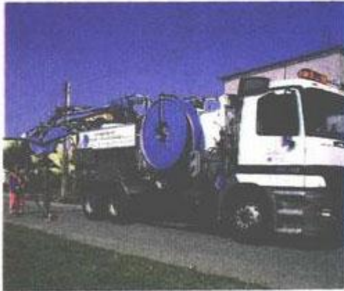
Samochód do ciśnieniowego czyszczenia sieci
